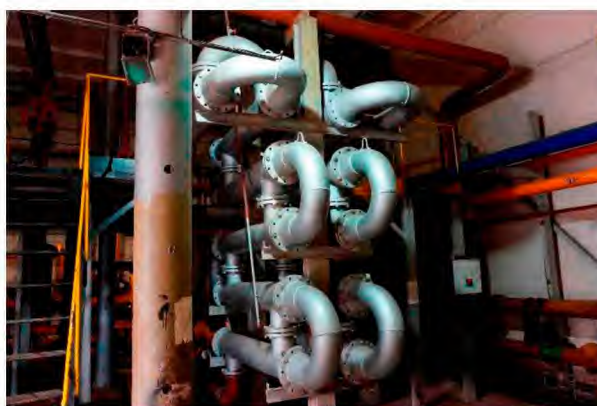
Рисунок 1.29 Визуальный осмотр ЦТП-5: теплообменник подготовки ГВС
