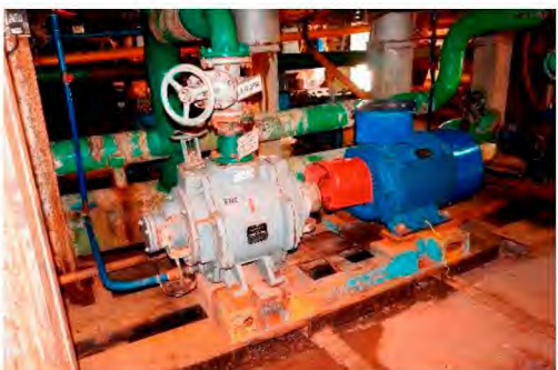
Рисунок 1.3 водокольцевой компрессор ВК-15 № 1,2,3
