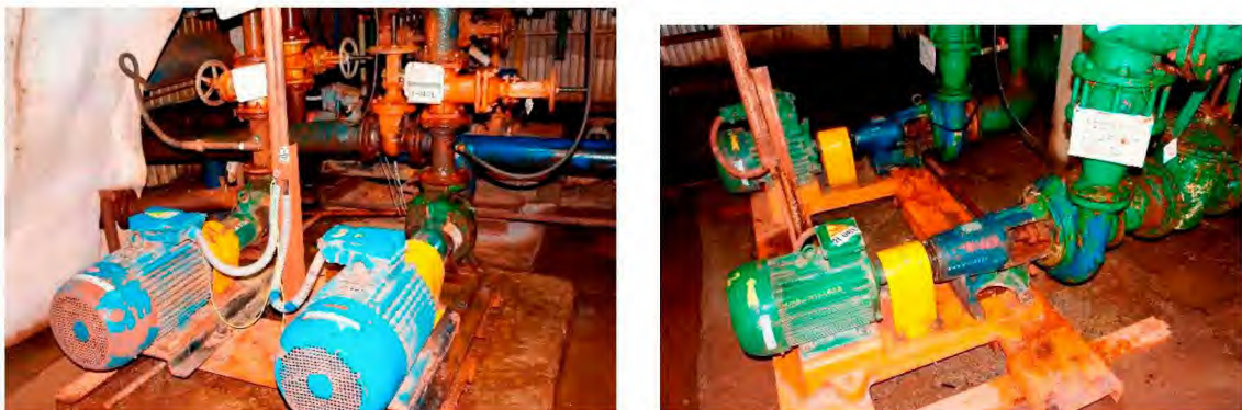
Рисунок 1.6 насосы перекачки воды с градирни на ФОВ и насосы промывки
