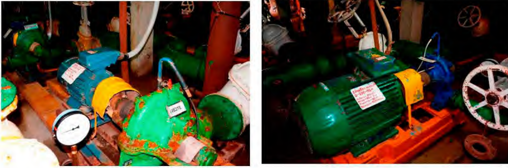
Рисунок 1.4. сетевые насосы № 1-4 подачи очищенной воды в сеть водоснабжения.
