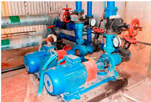
Рисунок 1.18 Визуальный осмотр ЦТП-2: насосы ХВС – 2 шт., , насосы ГВС – 3 шт. и корректирующие насосы (по отоплению) – 2 шт.
