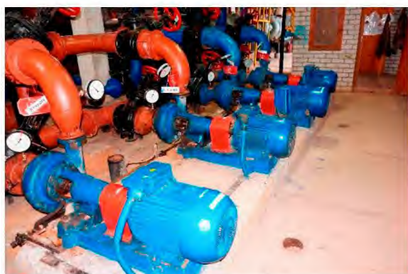
Рисунок 1.31 насосы ХВС – 2 шт. и корректирующие насосы (на отопление)- 2 шт.
