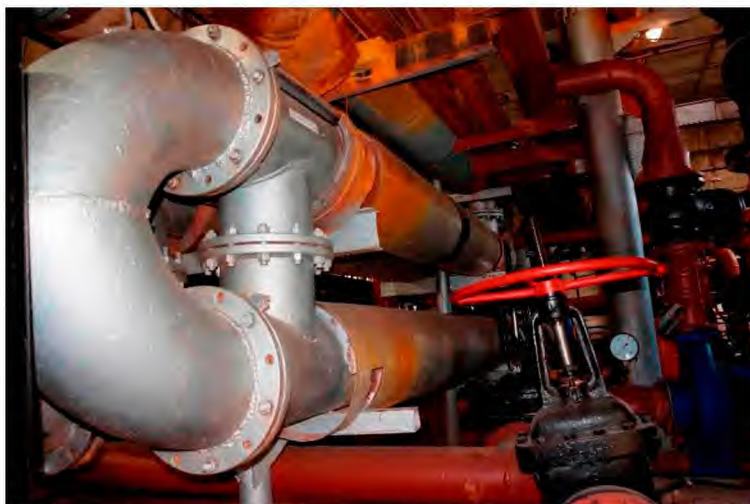
Рисунок 1.13 Визуальный осмотр ЦТП-1: теплообменник подготовки ГВС
