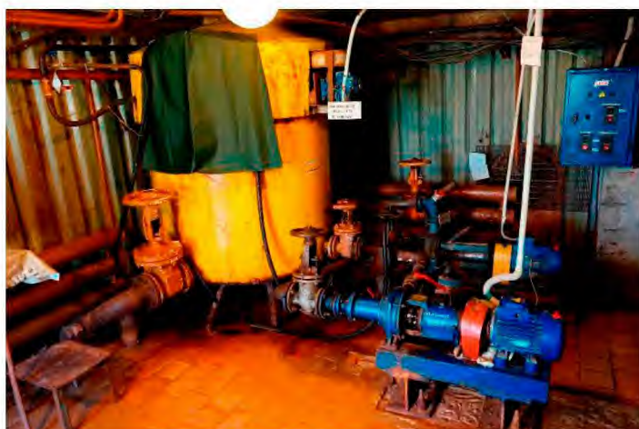
Рисунок 1.7 помещение подготовки раствора обеззараживания (бак и два насоса)
