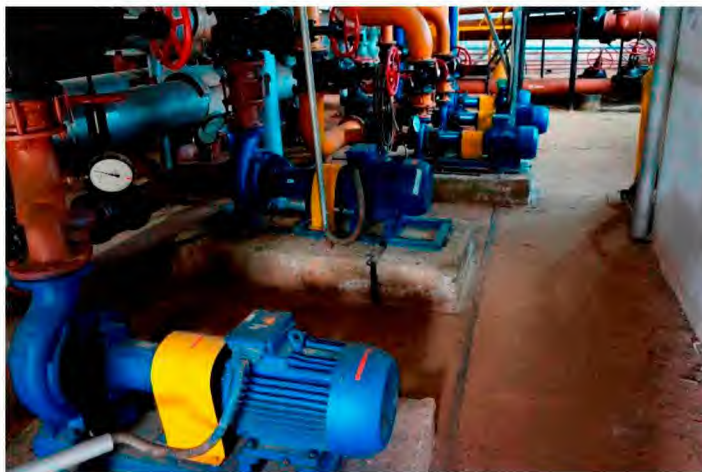
Рисунок 1.12 Визуальный осмотр ЦТП-1: корректирующие насосы (по отоплению) – 2 шт., насосы ГВС – 2 шт. и насос ХВС – 1 шт.
