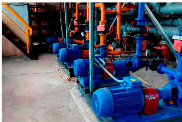
Рисунок 1.15 Визуальный осмотр ЦТП-1А: насосы ХВС – 2 шт., , насосы ГВС – 2 шт и корректирующие насосы (по отоплению) – 2 шт.
